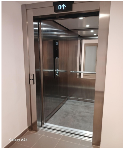
Ascenseur desservant les 2 étages
