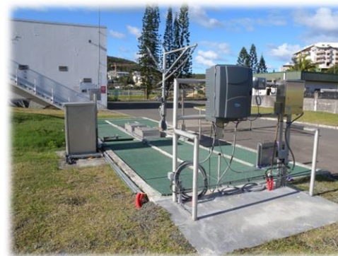
STEP Anse Vata - Préleveur eau traitée
