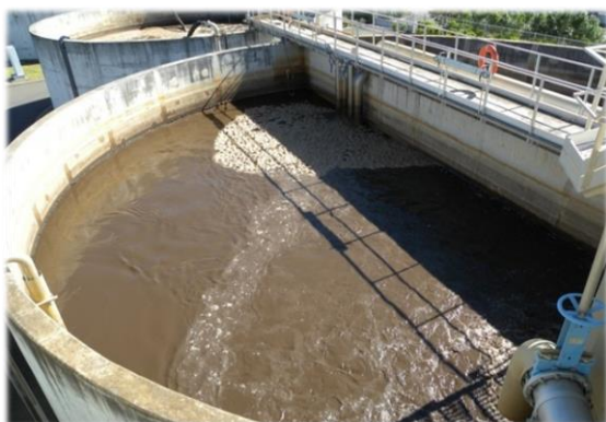
STEP James Cook- Bassin d'aération- Eau brute
